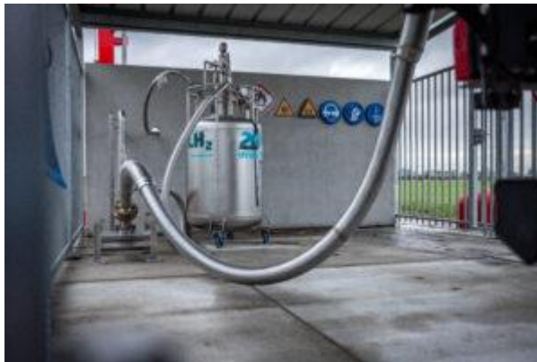
Figuur 9 Vloeibare waterstof installatie, bron: Rotterdam The Hague
